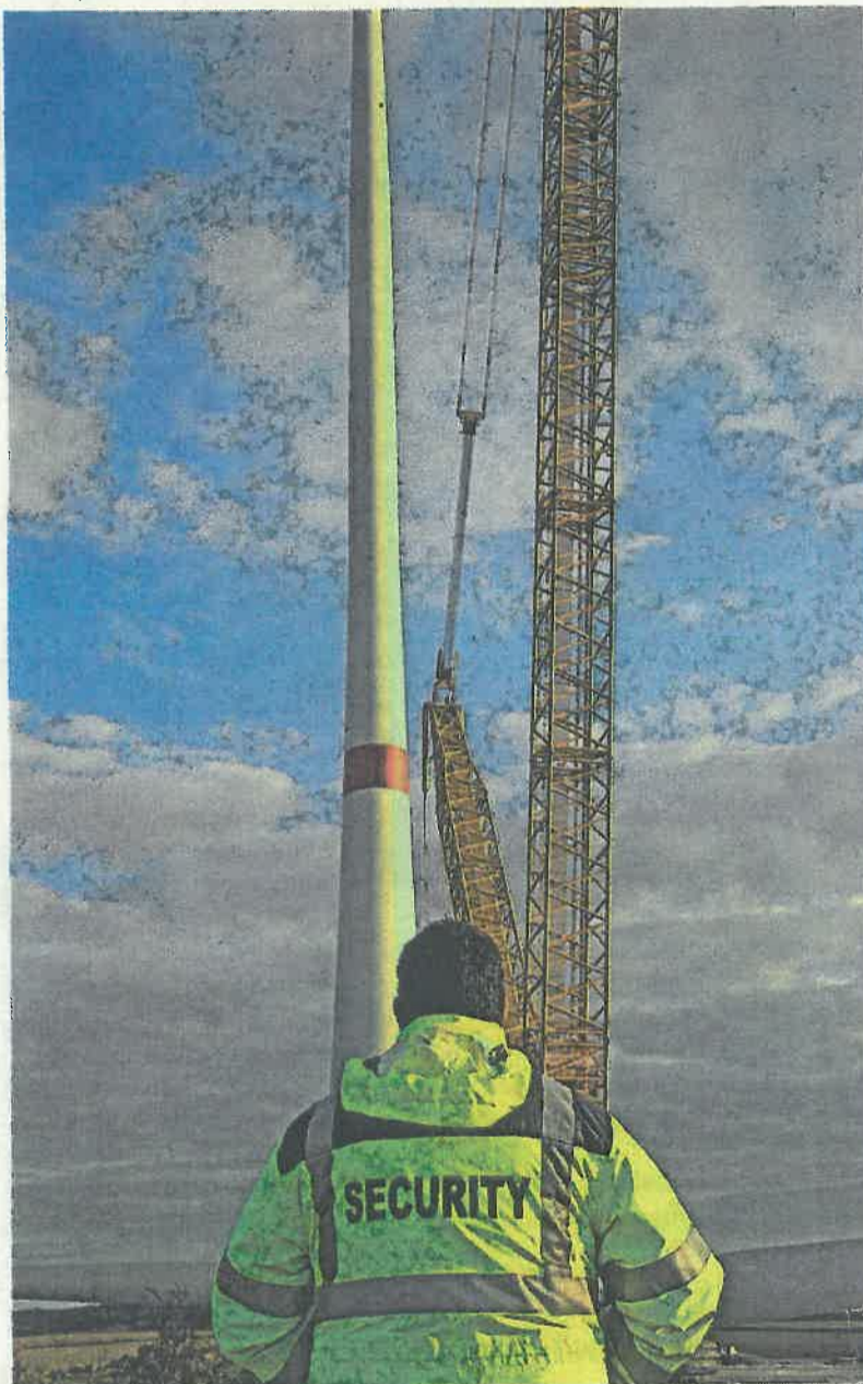
Die Genehmigungen für Windkraftanlagen sind aufwendig. In manchen Behörden gibt es damit bereits viel Erfahrung, in anderen sind sie Einzelfälle. FOTO: DPA
